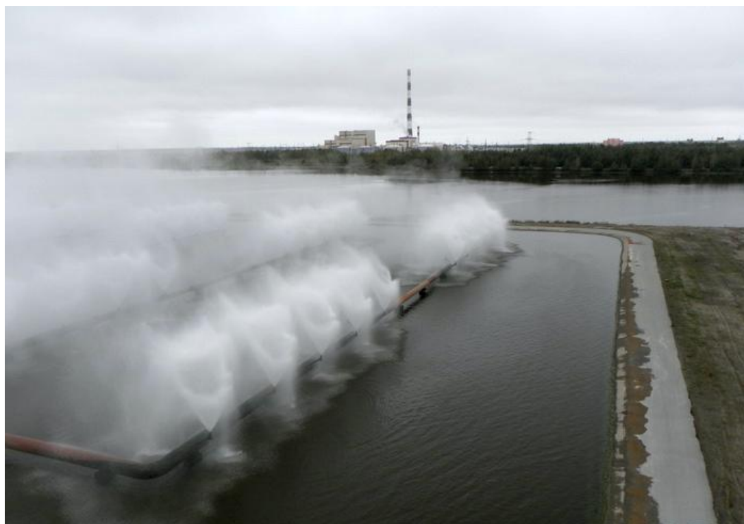
Рисунок 8 – Охладительный канал и бассейн Минской ТЭЦ-5
